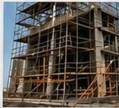
SCAFFOLDING SAFETY स्केफोल्डिंग सुरक्षा
